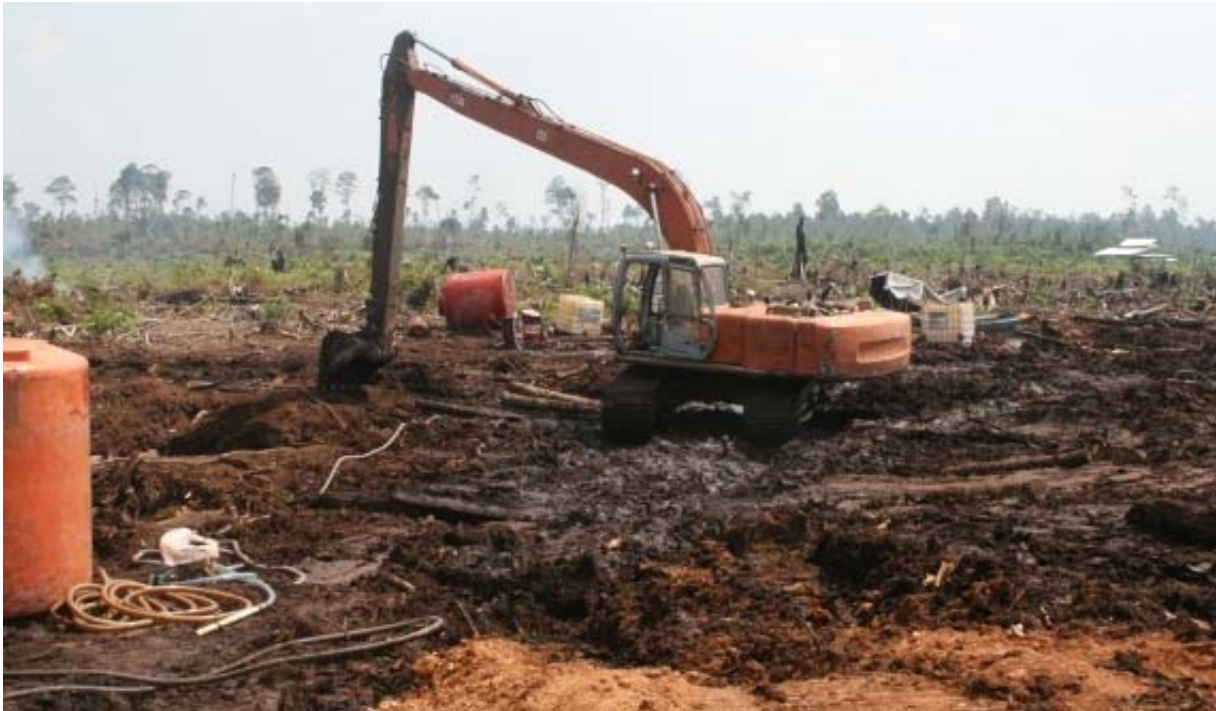
Foto 2. Satu unit ekskavator PT Sumatera Riang Lestari tengah menggali kanal di hutan rawa gambut Kerumutan.
